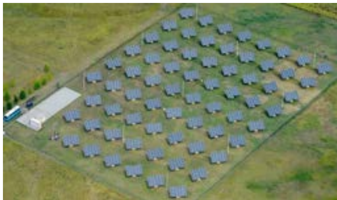
Fig. 4.15.4. Solar panel farm in Újszilvás.
